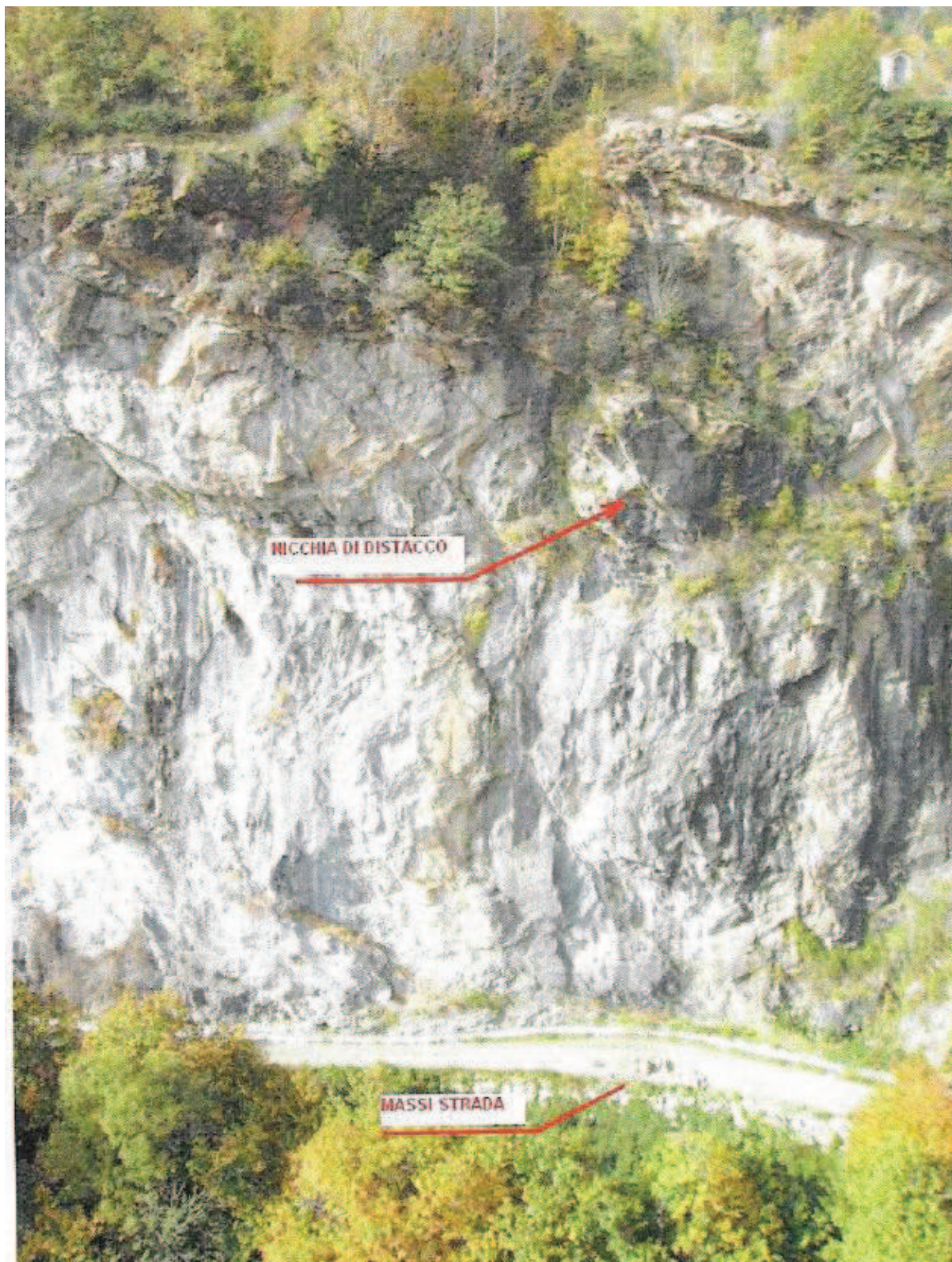
Foto 44 – Blocco E (rimosso) di ca 4mc legato al fenomeno di crollo del 2005 che ha coinvolto la viabilità di accesso alla vasca (fotografie tratte da Bolognini)
