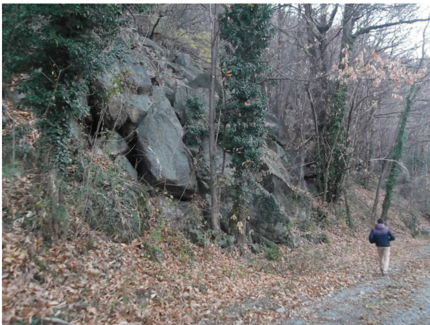
Foto 33 – Differente prospettiva del margine meridionale della falda detritica di quota 500m. In evidenza l'accatastamento di grandi blocchi da cui si è generato il dissesto del 2010.
