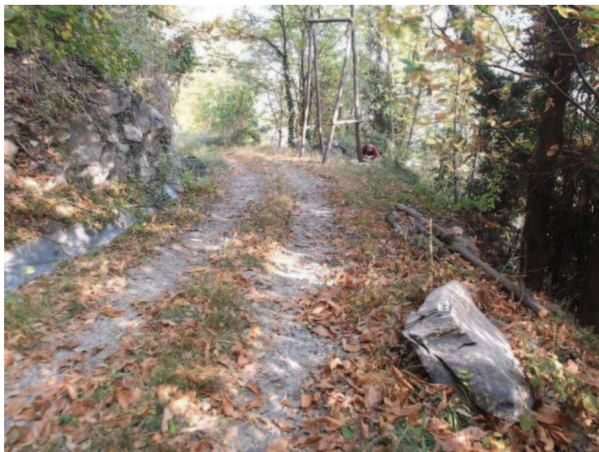
Foto 05 – Blocco 1 di marmo di 0.3mc sul lato di valle della strada poderale molto probabilmente relativo al fenomeno di crollo avvenuto nel 2007
