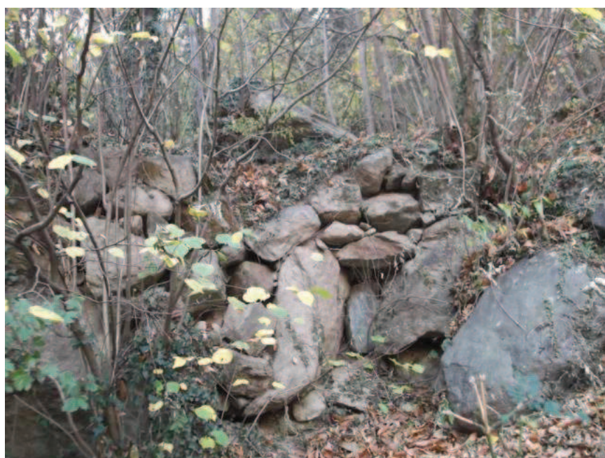
Foto 13 – Blocco di circa 1mc costituente un muro a secco instabile.
