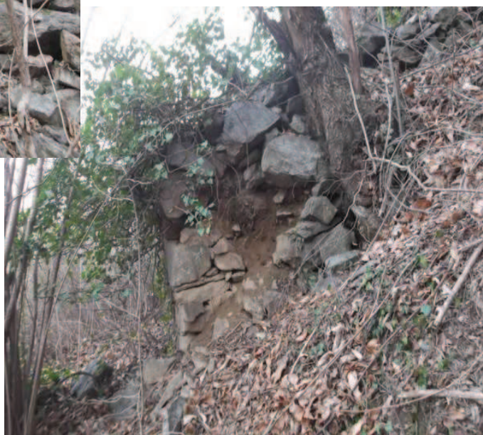
Foto 50 – Situazione 37. Esempio di muratura di terrazzamento in disfacimento, posta poco a monte della strada comunale presso il municipio. Sono presenti in questo caso blocchi pericolanti di volume fino a 0,1 mc.
