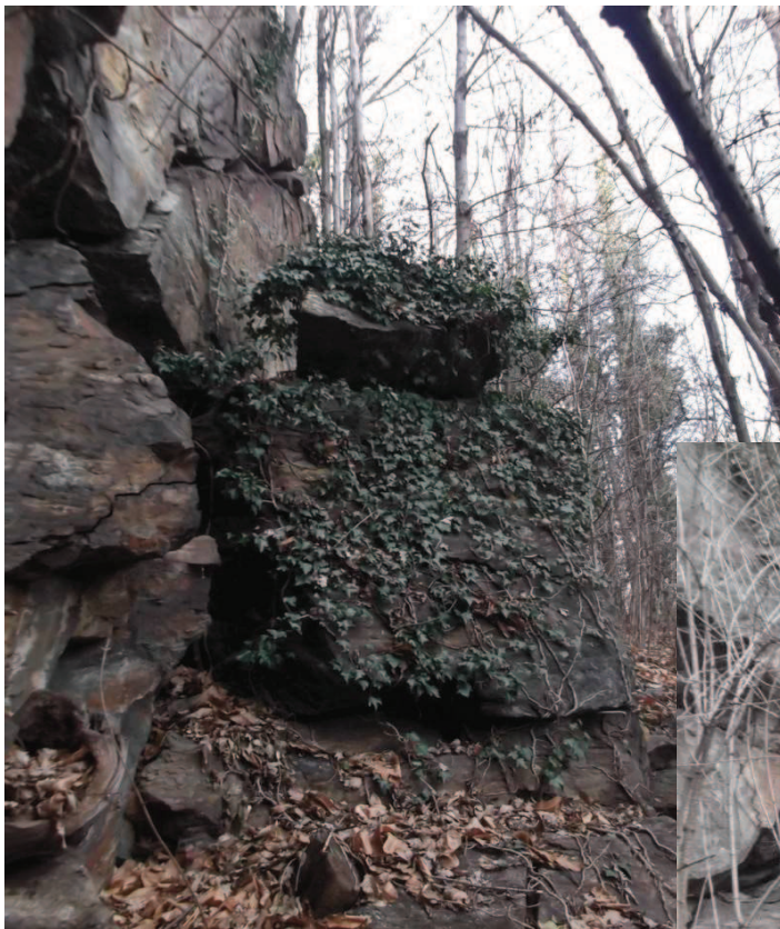
Foto 45-46-47 – Situazione 34-35. Settore di affioramento roccioso disarticolato, con blocchi isolati da ampie fessurazioni (comparto roccioso da 30-40 mc e blocchi 10-20 mc) posto a q. 380 m ca.. A valle è presente una falda detritica recentemente alimentata (foto sotto) con blocchi di volume fino a 0,5 mc.
